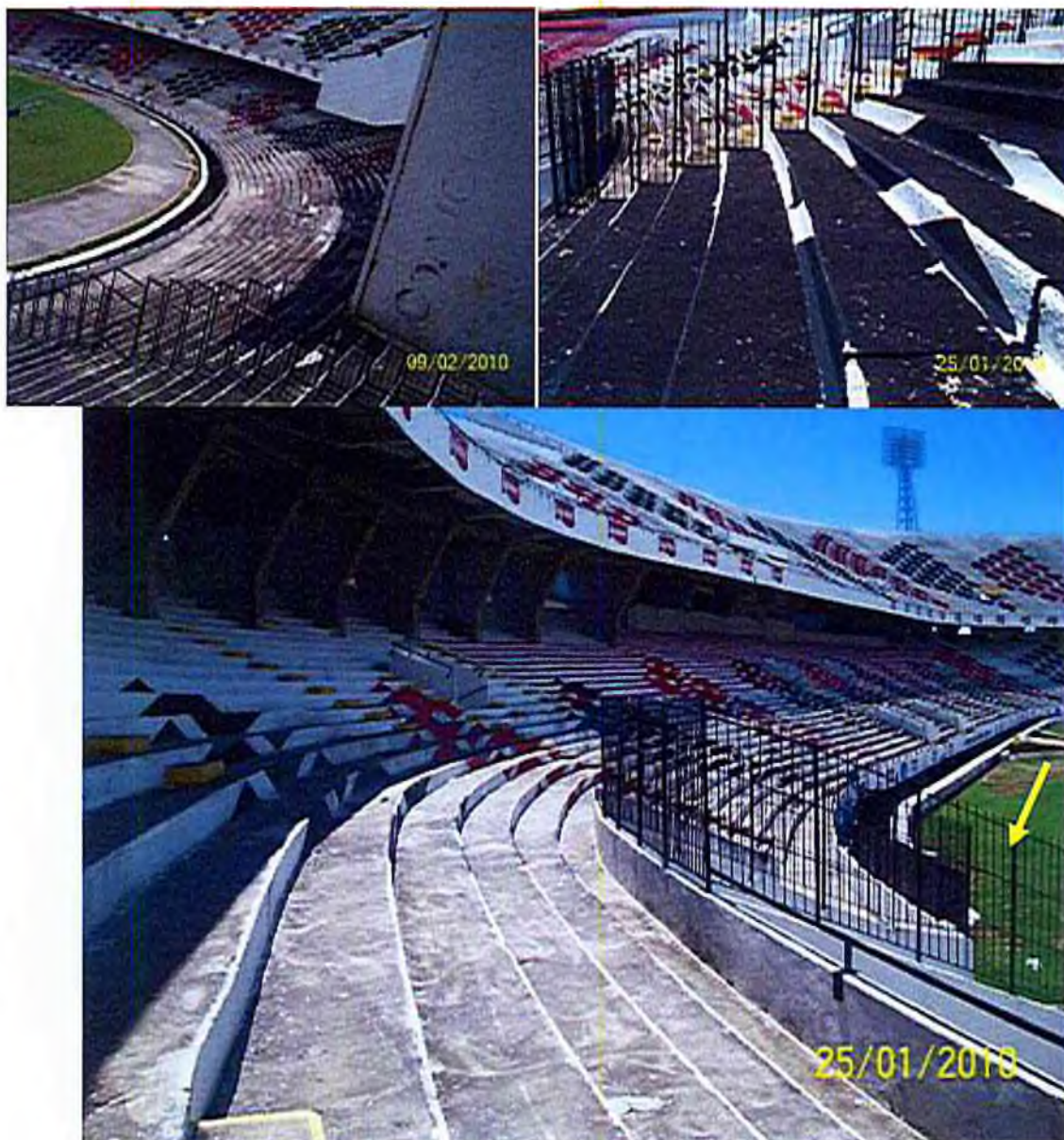
Gradis de Proteção aos Acessos de Viaturas ao Campo de Futebol
