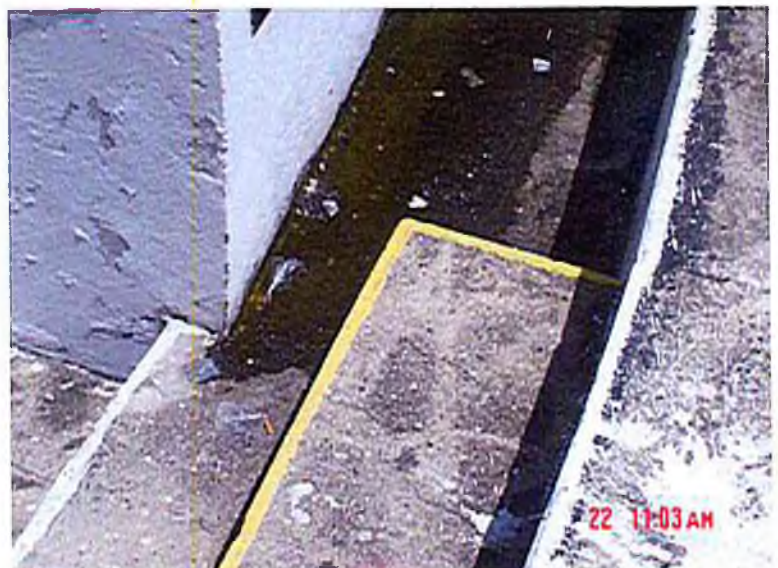
REVESTIMENTOS DE PISO IRREGULARES ANEL INFERIOR SOCIAIS NIVEL 2
